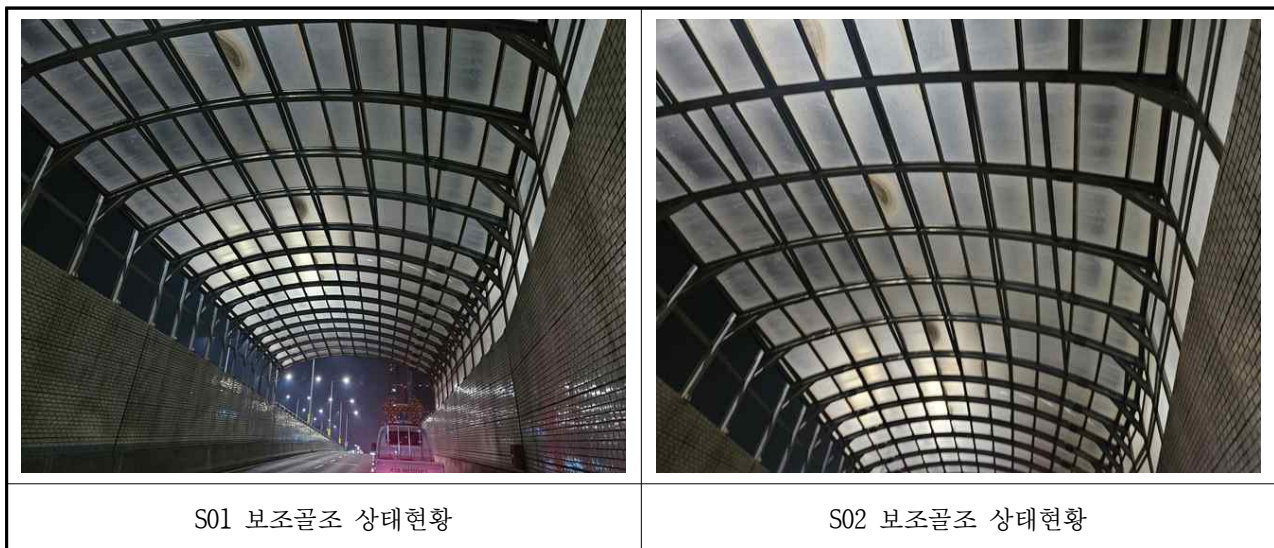
【사진 3.4.4】 보조골조 손상현황
