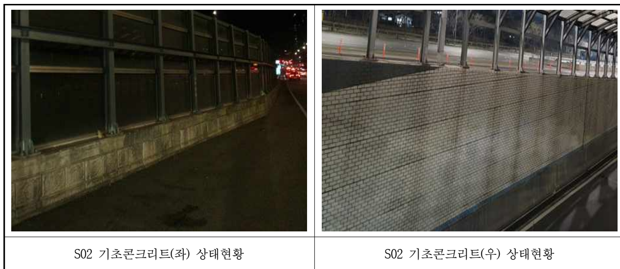
【사진 3.4.8】 기초콘크리트 손상현황(계속)
