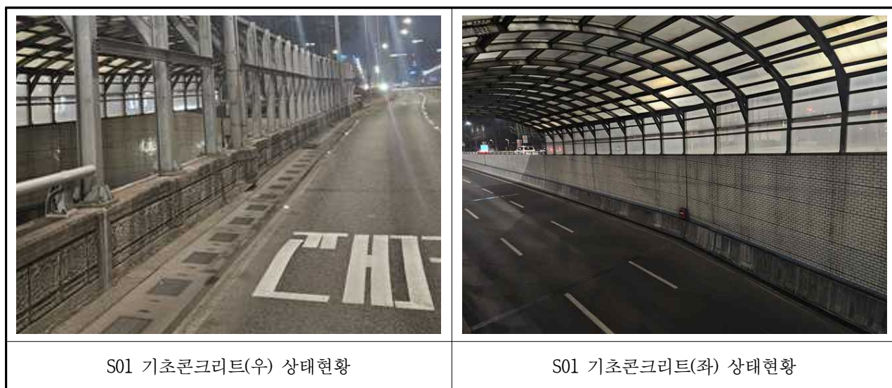
【사진 3.4.8】 기초콘크리트 손상현황
