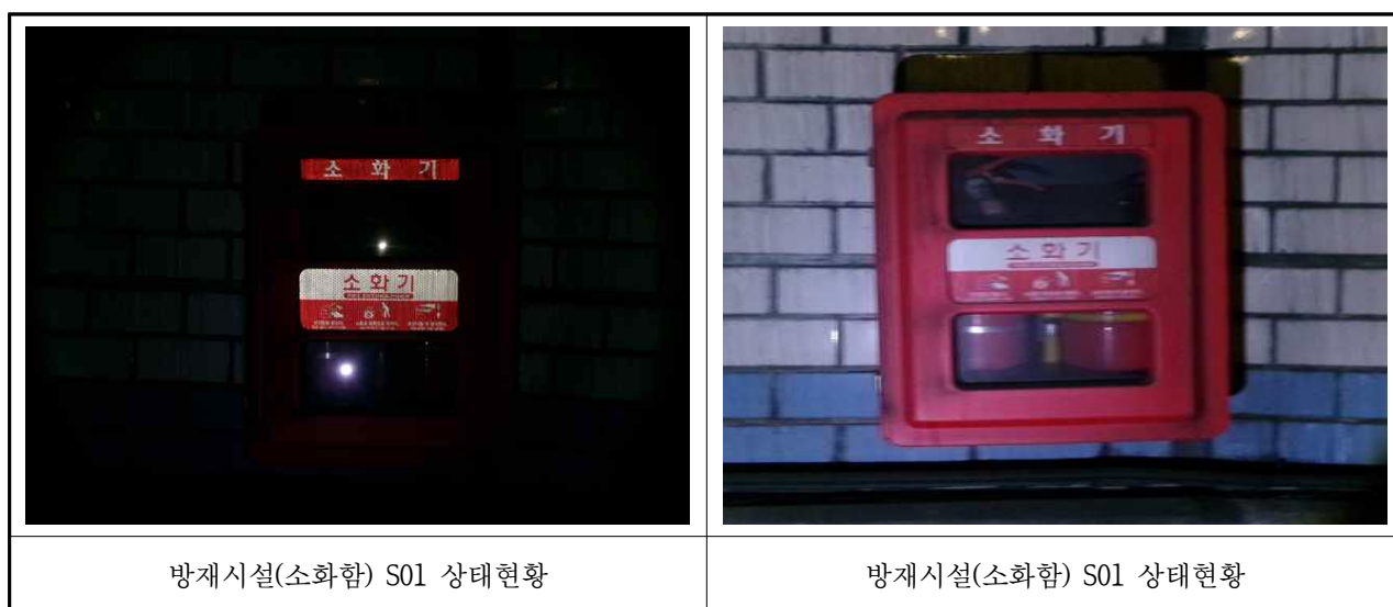
【사진 3.4.17】 방재시설 손상현황
