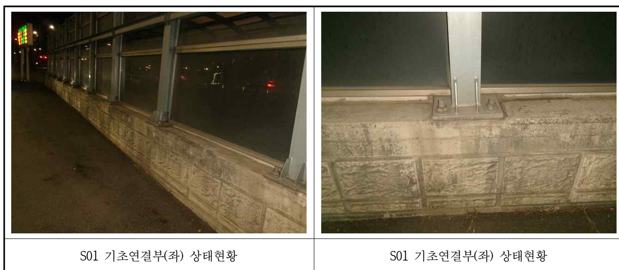
【사진 3.4.6】 기초연결부 손상현황
