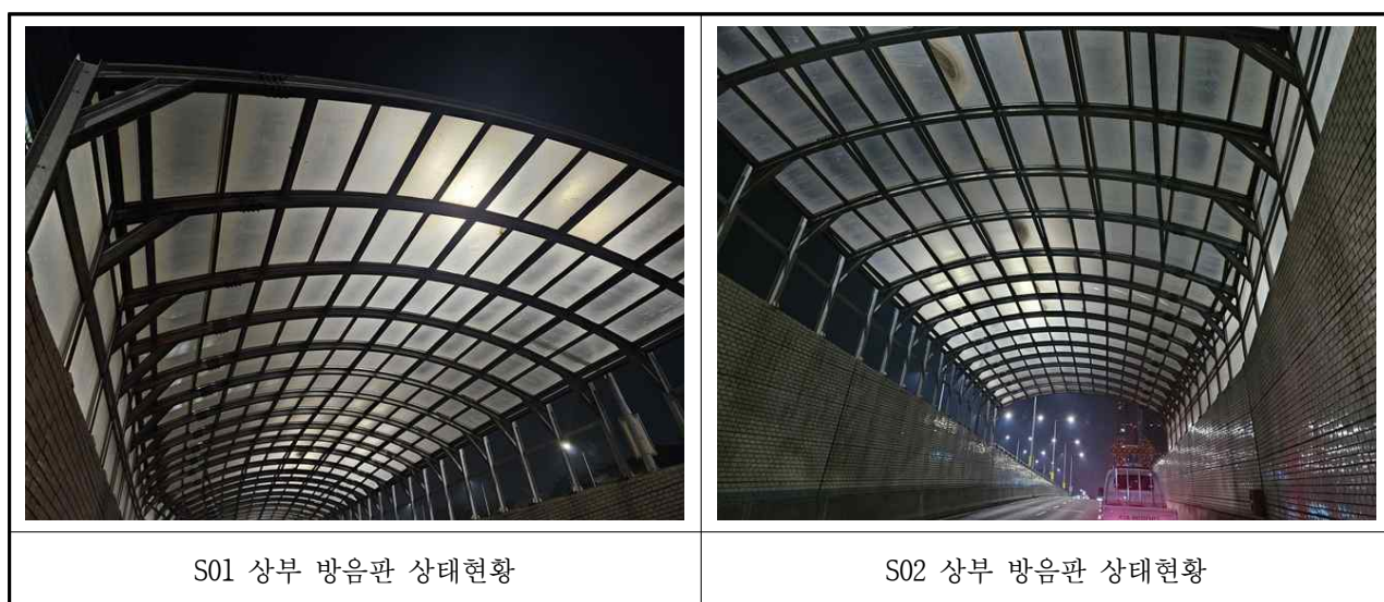
【사진 3.4.10】 방음판 손상현황
